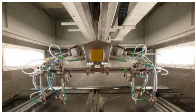
Im Rahmen der Modernisierung wurde die neueste Sprimag Applikationstechnik implementiert.
