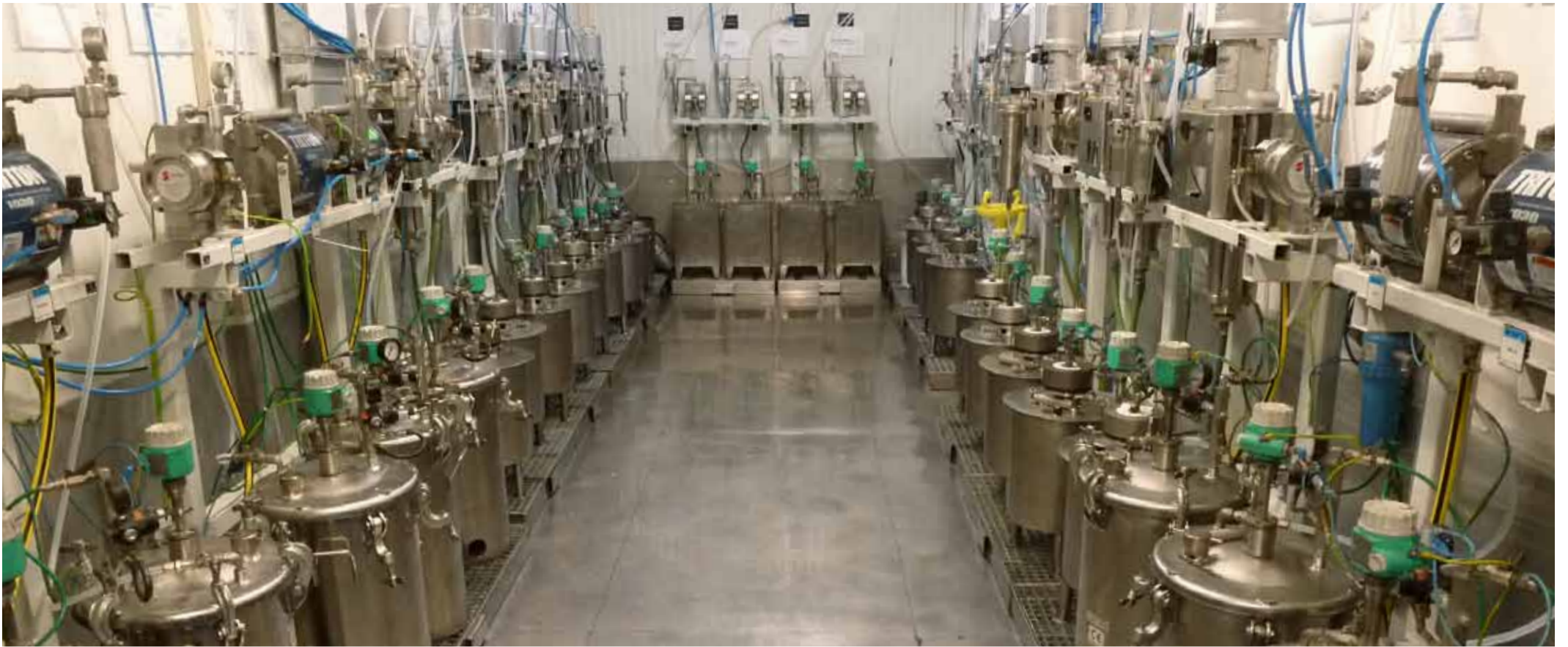
Die 43 Versorgungstanks werden zentral koordiniert und von einer Software gesteuert.
